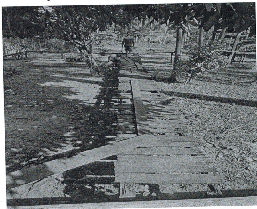
Imagem 02- Passarela de acesso igreja/escola em péssimas condições.
