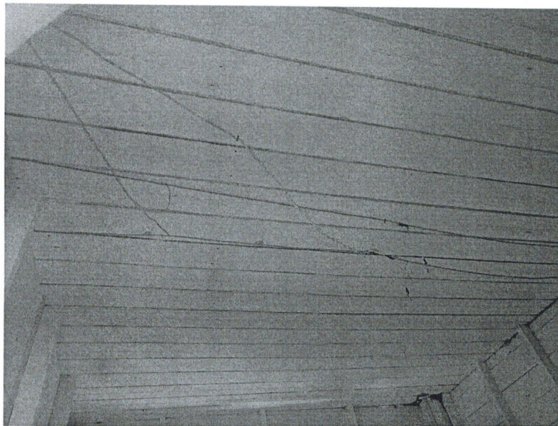
Imagem 14 - Cabo elétrico exposto.
