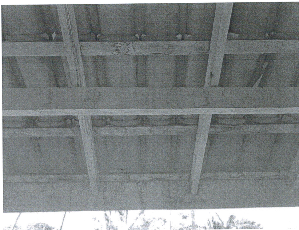
Imagem 28 – Ripas e lambrequim deterioradas.
