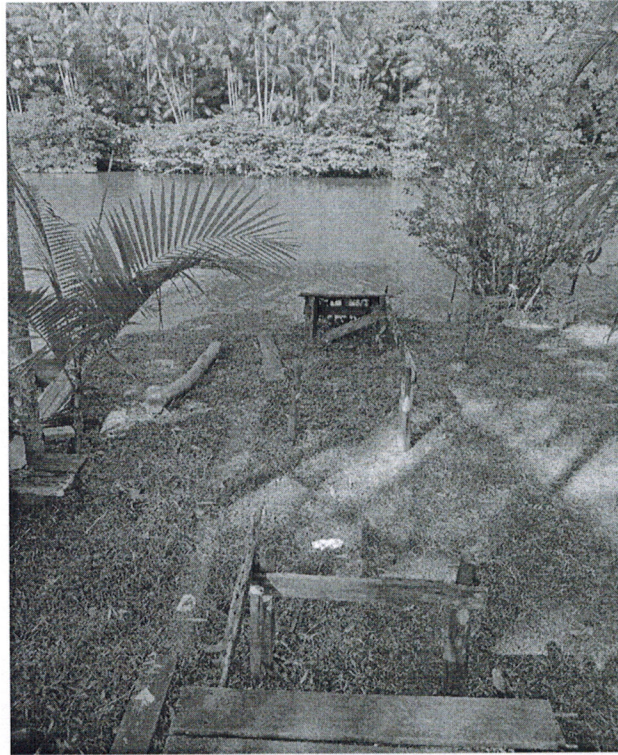
Imagem 03- Passarela de acesso à escola inexistente.
